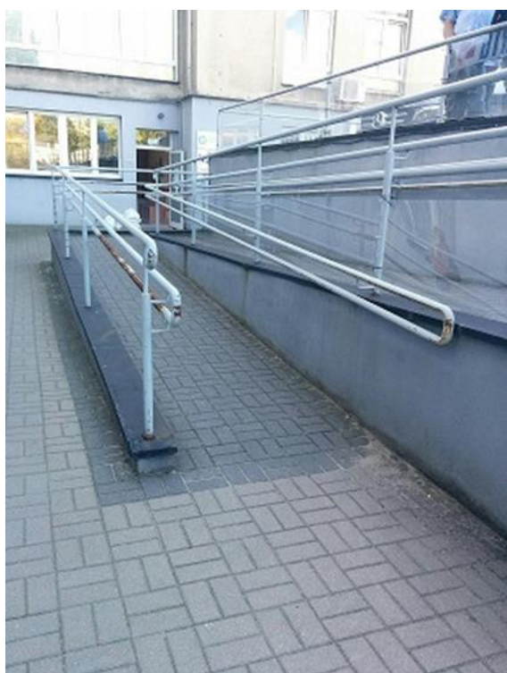
Zdjęcie nr 3. Nieprawidłowa pochylnia przy wejściu głównym
