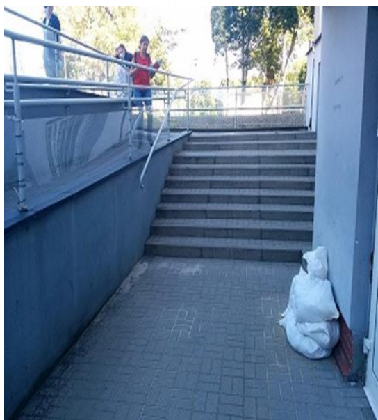
Zdjęcie nr 4. Nieprawidłowe schody przy wejściu głównym
